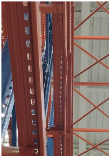
Fotografía 14. Carril mal estado
